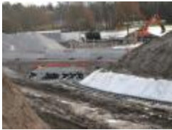
Kabel under väg (DS2015-00389)
